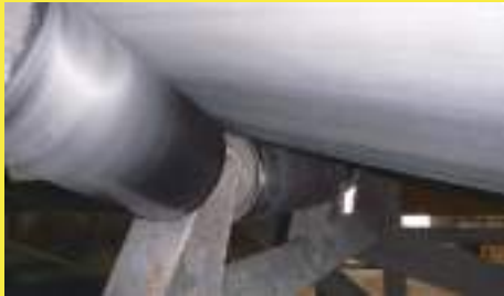
▲ ローラ間への落ち込みによるベルト裏面の損傷
