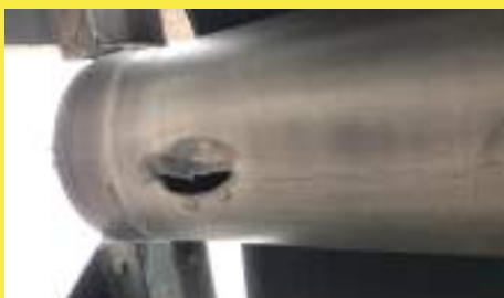
▲ プーリ表面の摩耗が進行し、パイプ面に穴あき発生
