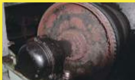
▲ プーリ本体の腐食による強度の低下（破損のおそれ）
