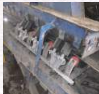
▲ テール部ベルト蛇行対策
